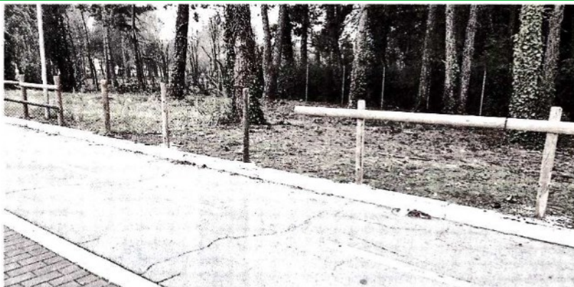
Lo scorso dicembre i vandali avevano staccato parte della staccionata che divide il parco dalla bicipolitana
